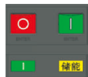
断路器合闸且已储能完毕状态
